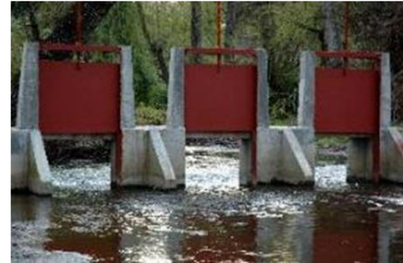
Compuertas de riego
